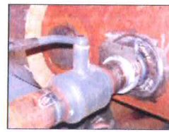
5. Angeschweisste Absperrvorrichtung (Kugelhahn) und Rohr-Abzweig
