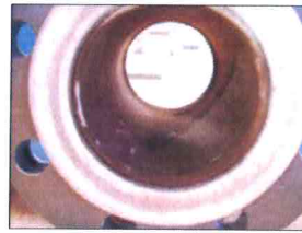
Querschnitt des MID nach Ausbau (Wulst in der Auskleidung)
